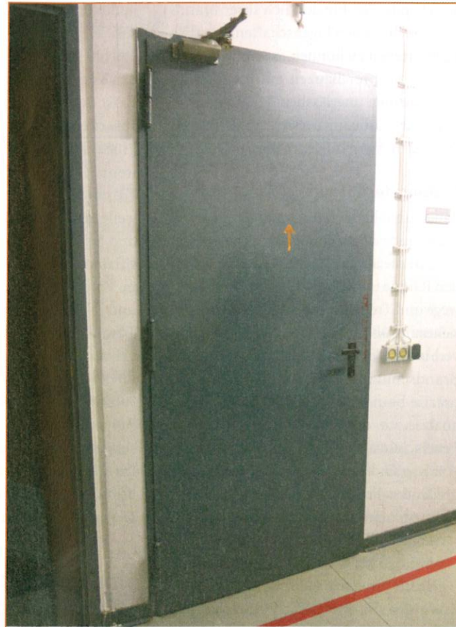
Abb. 4: Bauartgleicher Feuerschutzabschluss, jedoch abweichend eingebaut
