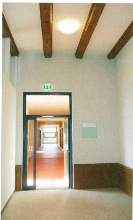
Abb. 2: Gestattung einer Erleichterung: Hölzerne Lambris in einem notwendigen Flur
