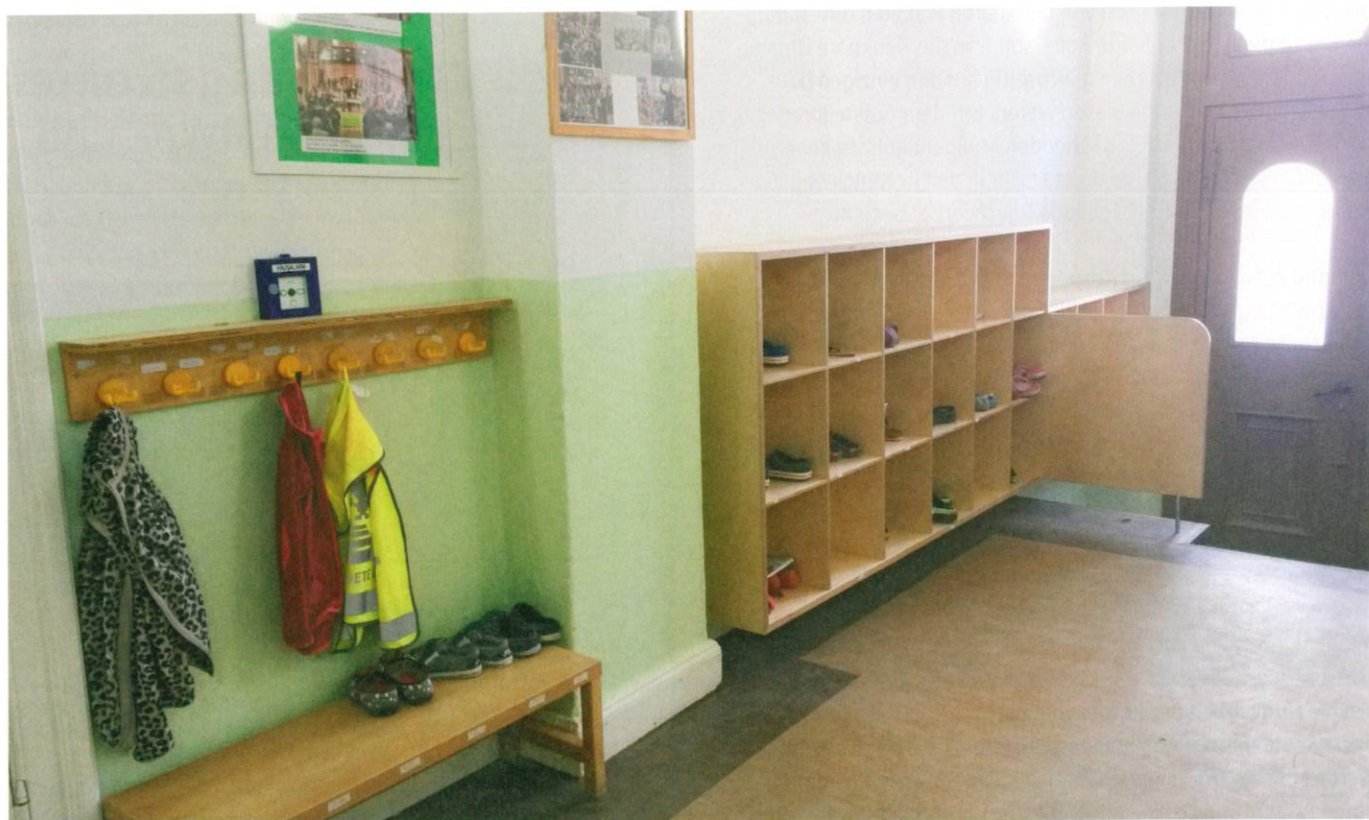
Abb. 5: Neue einvernehmliche Lösung: Zustand nach Durchsetzung der Maßnahmen (s. Beispiel 2)
